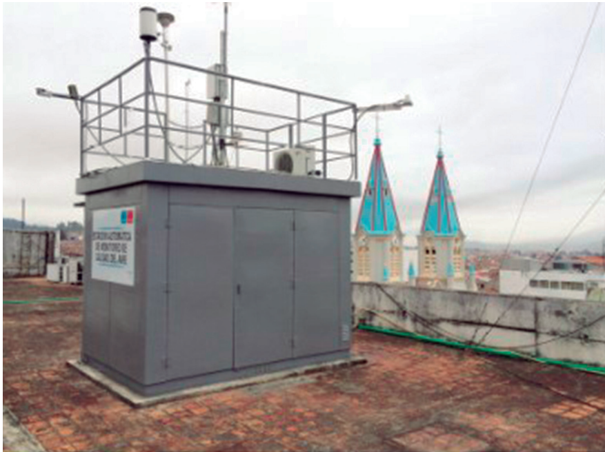
Figura 1. Estación para el monitoreo automático de calidad del aire, localizada en el Municipio (estación MUN en Figura 2) Fuente: (Municipalidad de Cuenca, 2015)
