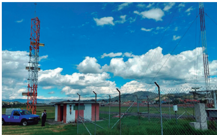
Figura 12. Estación AWOS ubicada en el Aeropuerto Mariscal Lamar
