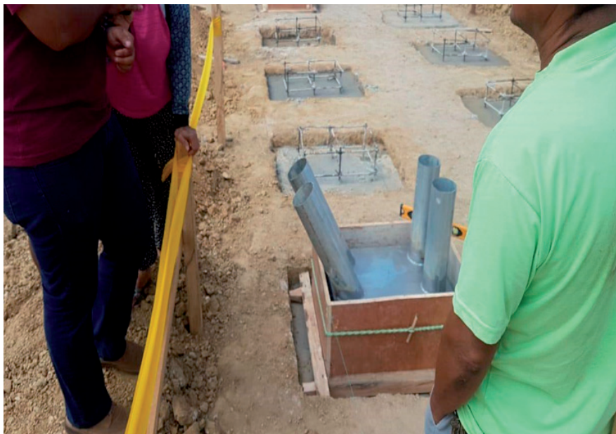
Figura 14. Replanteo General y espacios excavados para colocar plintos donde se fundieron. Fuente: Estudiantes de vinculación, (2018).
