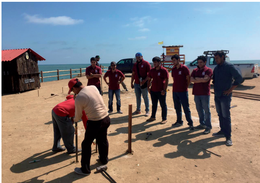
Figura 12. Reconocimiento del sitio donde se construyó la obra por parte de estudiantes de Etapa 3 e inicio de excavaciones para replanteo. Fuente: Estudiantes de vinculación, (2018).
