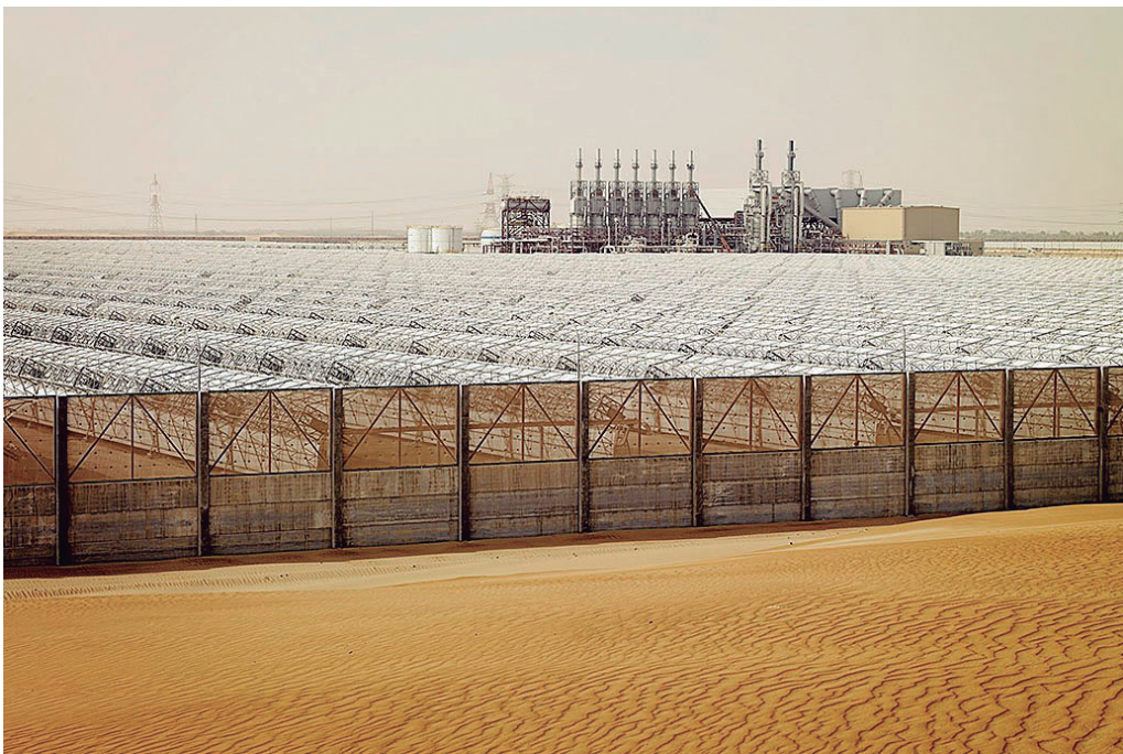
Figura 6. Shams 1. Planta de energía solar. (Antony, T., s.f).
