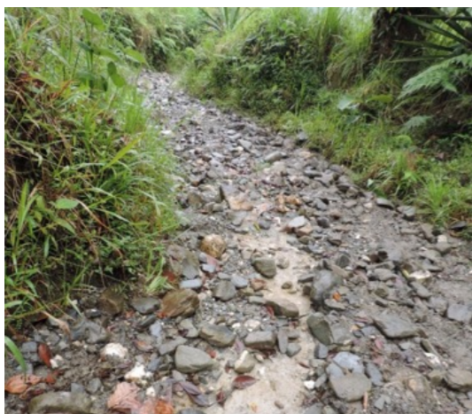
Vía con piedras dispersas sobre afloramiento rocoso y talud lateral
